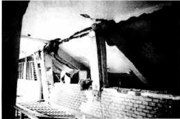
Figura 2-11. Falla de nudos por falta de refuerzo trasversal, Armenia, Colombia. Recuperado de: http://smis.mx/index.php/RIS/article/viewFile/225/163 . Consultado: 08/03/2016.
