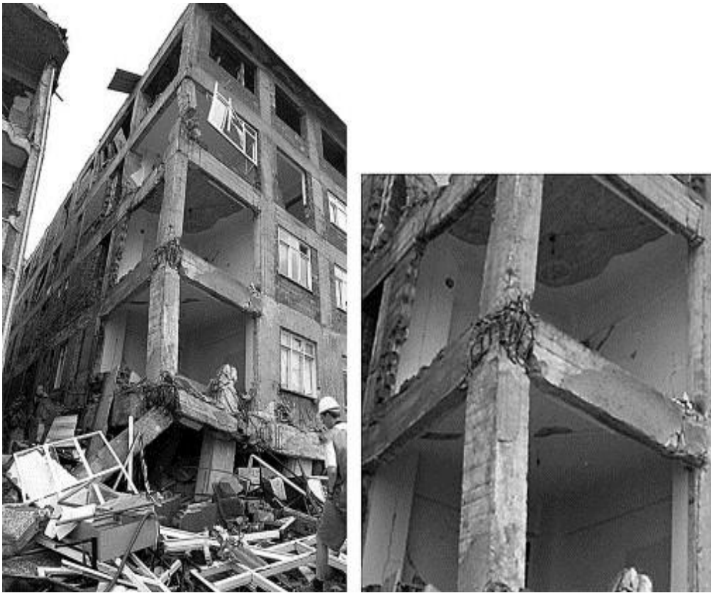
Figura 2-4. Fallo de nudo de edificio en Turquía, sismo año 1999. Recuperado de: http://ia.espe.edu.ec/wp-content/uploads/2013/02/Conexiones-viga-columna.pdf . Consultado: 4/3/2016.
