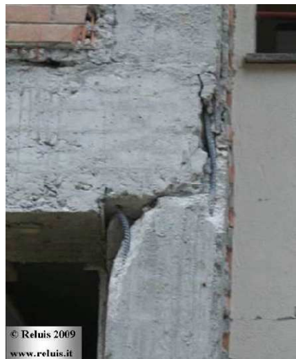
Figura 2-9. Falla en nudo por concreto de mala calidad, Italia. Recuperado de: http://civilgeeks.com/2014/01/19/comportamiento-y-diseno-de-nudos-de-concreto-armado/ . Consultado: 8/03/2016
