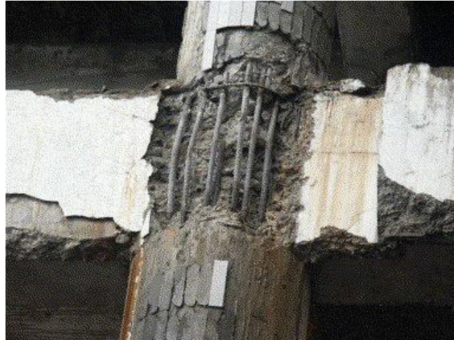
Figura 2-7. Falla en nudo por falta de refuerzo transversal. Recuperado de: http://ia.espe.edu.ec/wp-content/uploads/2013/02/Conexiones-viga-columna.pdf . Consultado: 4/3/2016
