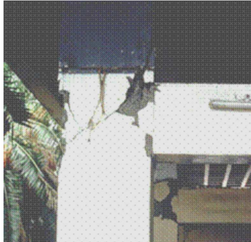
Figura 2-5. Fallo común por contante en nudo, edificio en Turquía, sismo 1999.
