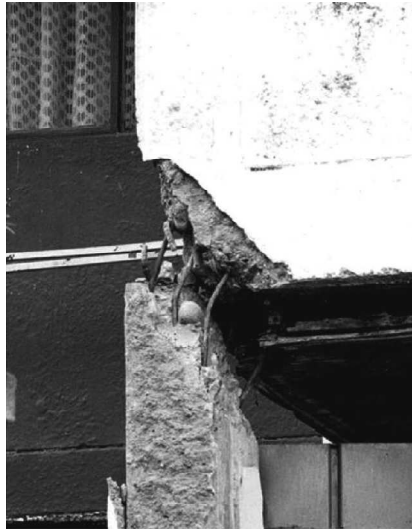
Figura 2-10. Falla en nudo por falta de refuerzo de confinamiento y mala calidad del concreto, Armenia, Colombia. Fuente: (Rochel, 2012)
