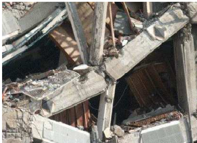
Figura 2-6. Fallo en nudo, centro comercial Panta Park, Asia, terremoto y tsunami 2004.
