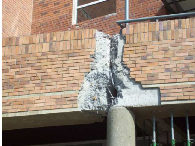
Figura 2-8. Falla de nodo por cortante, Santiago de Chile. Recuperado de: http://civilgeeks.com/2014/01/19/comportamiento-y-diseno-de-nudos-de-concreto-armado/ . Consultado: 8/03/2016
