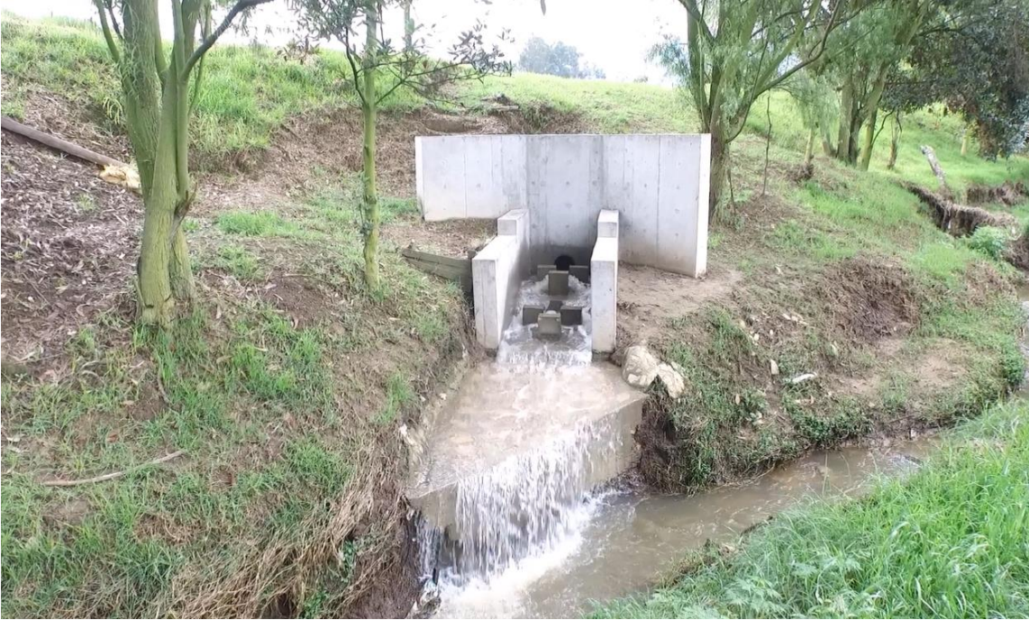
Figura 18. Estructura de Vertimiento
