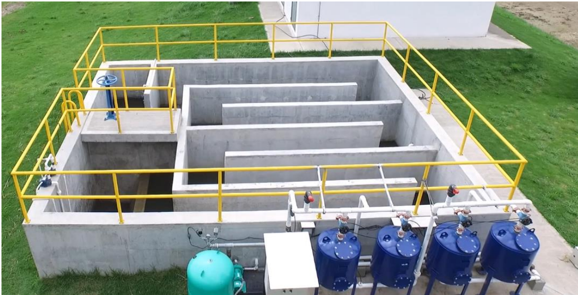
Figura 16. Tanque de Contacto
