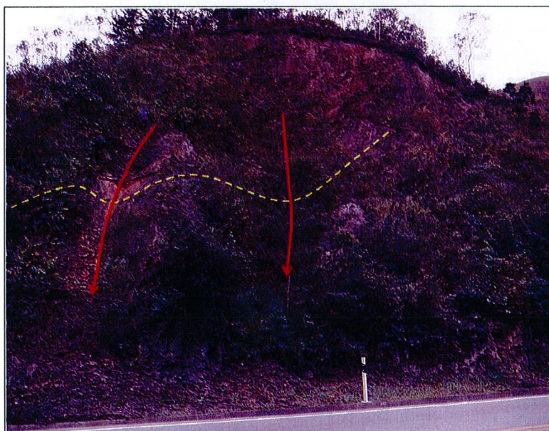
Figura 3-20 Talud del K38+800, se muestra en línea amarilla discontinua el plegamiento y en línea roja la dirección de los bloques desplazados.
