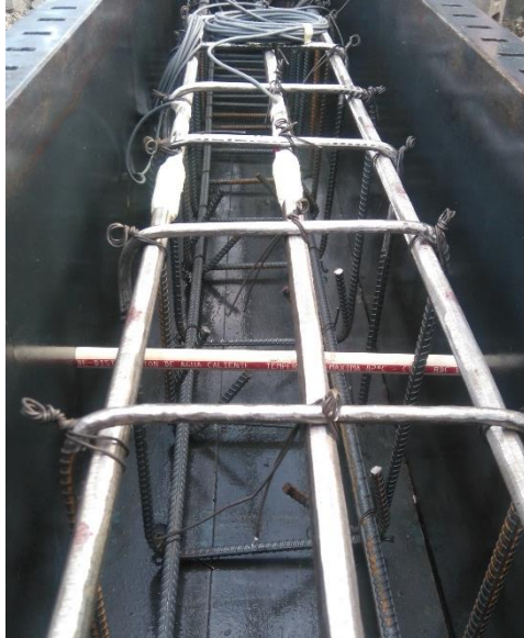
Fotografía 4.4 Pérdida de los resaltes y sección transversal en los estribos y acero longitudinal
