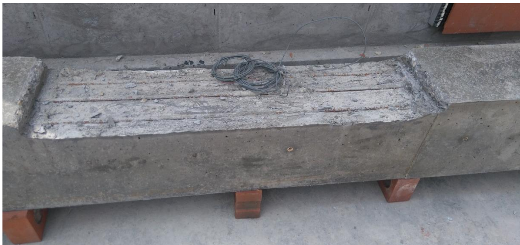
Fotografía 4.8 Estado final de la viga antes de la reparación.
