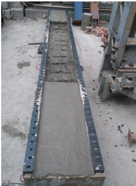
Fotografía 4.5 Estado final de la viga antes de la reparación
