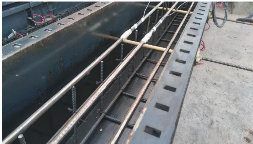
Fotografía 4.9 Simulación de la corrosión en la viga V3
