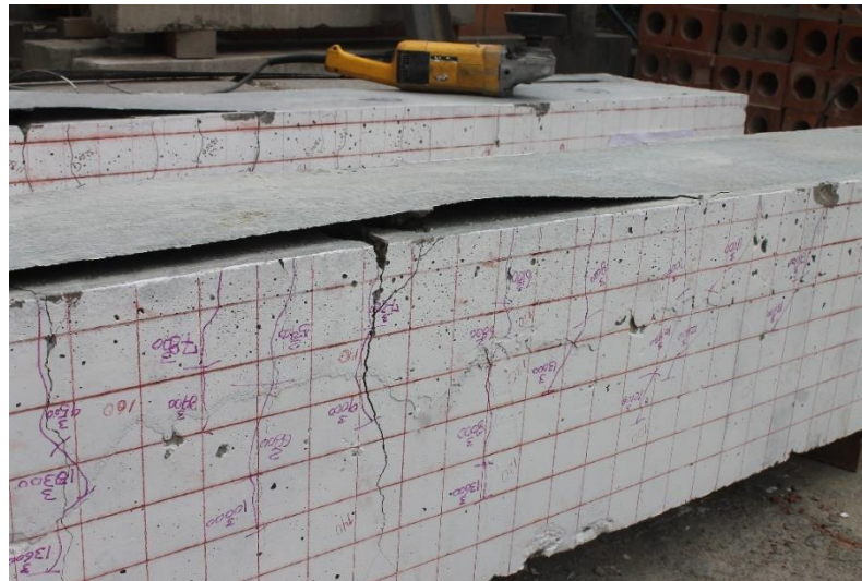
Fotografía 5.6 Delaminación del CFRP en la viga V5
