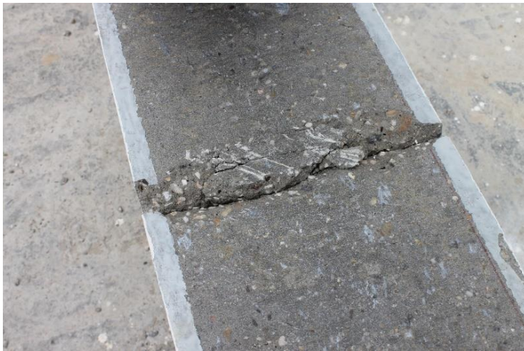
Fotografía 5.4 Fisuras en la cara en tracción de la viga V3
