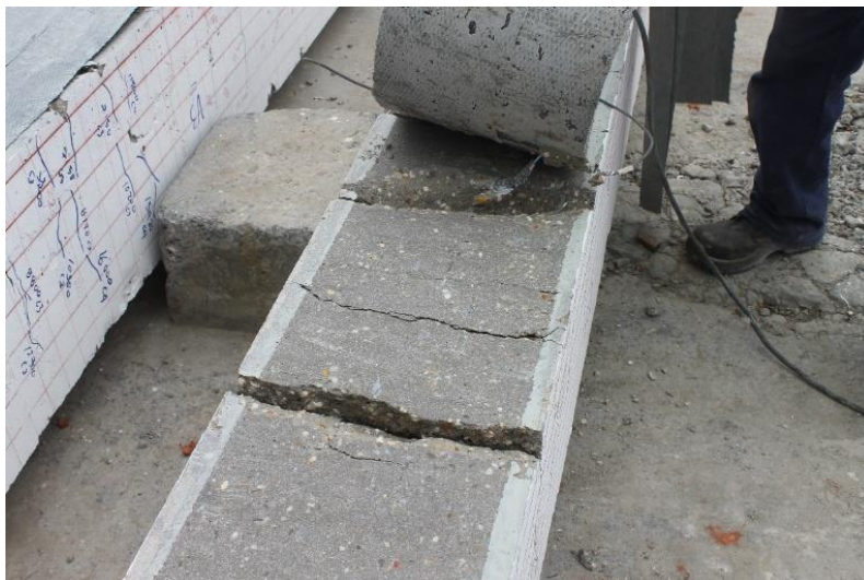
Fotografía 5.2 Fisuras en la cara en tracción de la viga V5
