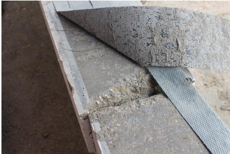
Fotografía 5.1 Fisuras en la cara en tracción de la viga V4
