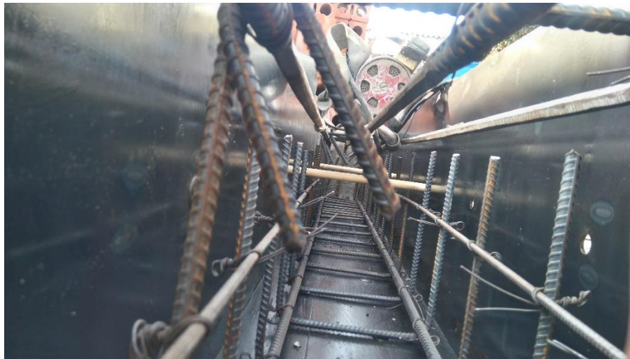
Fotografía 4.6 Aceros longitudinal y transversal afectados por corrosión
