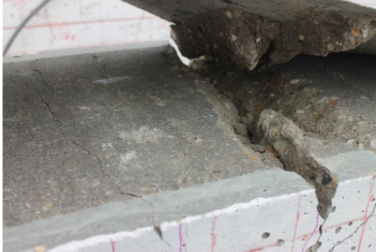
Fotografía 5.3 Fisuras en la cara en tracción de la viga V7
