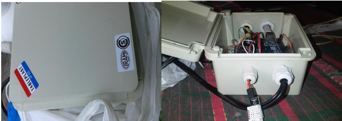
Figura 46G (foto izquierda) Caja con cerramiento Norma IP54 con módulos electrónicos de medida. Figura 46H (foto derecha) interior de la caja con tarjeta Arduino, sensores de voltaje, corriente, humedad-temperatura.
