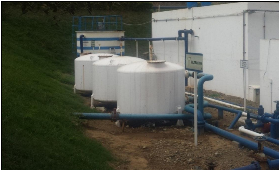
Foto 8. Batería de filtración
