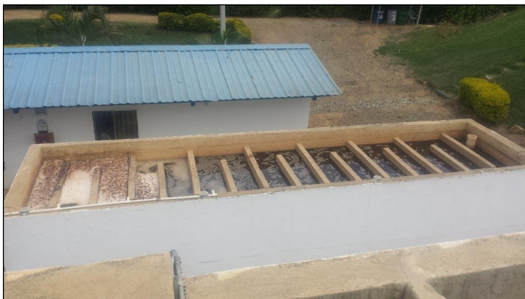
Foto 7. Tanque de contacto con cloro
