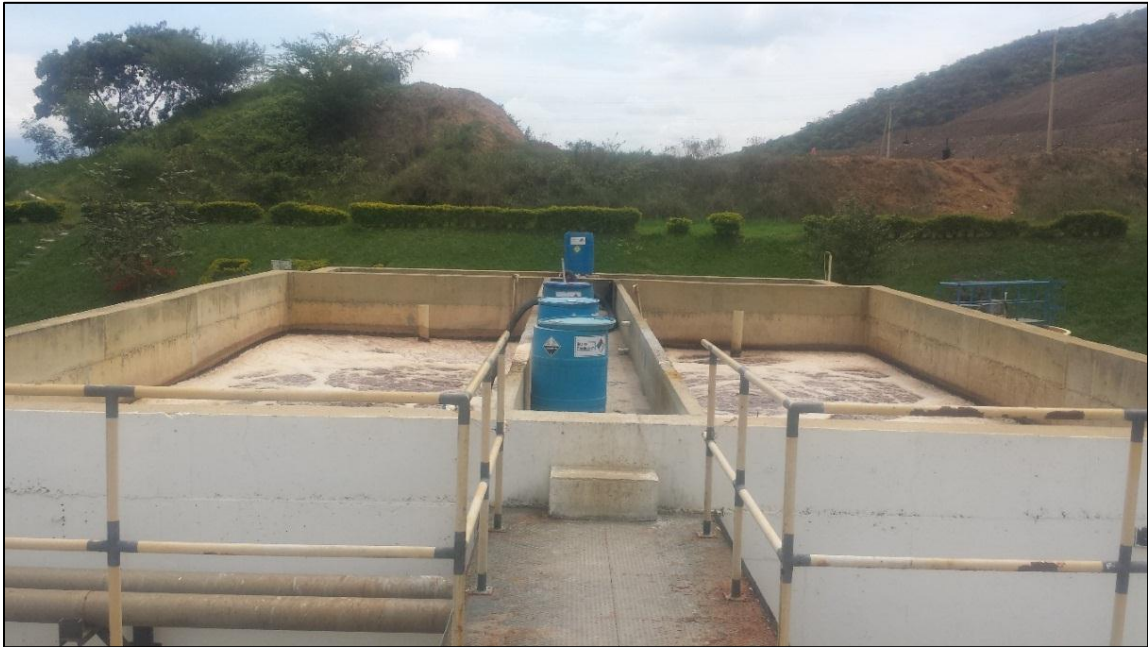
Foto 5. Tanque de aireación
