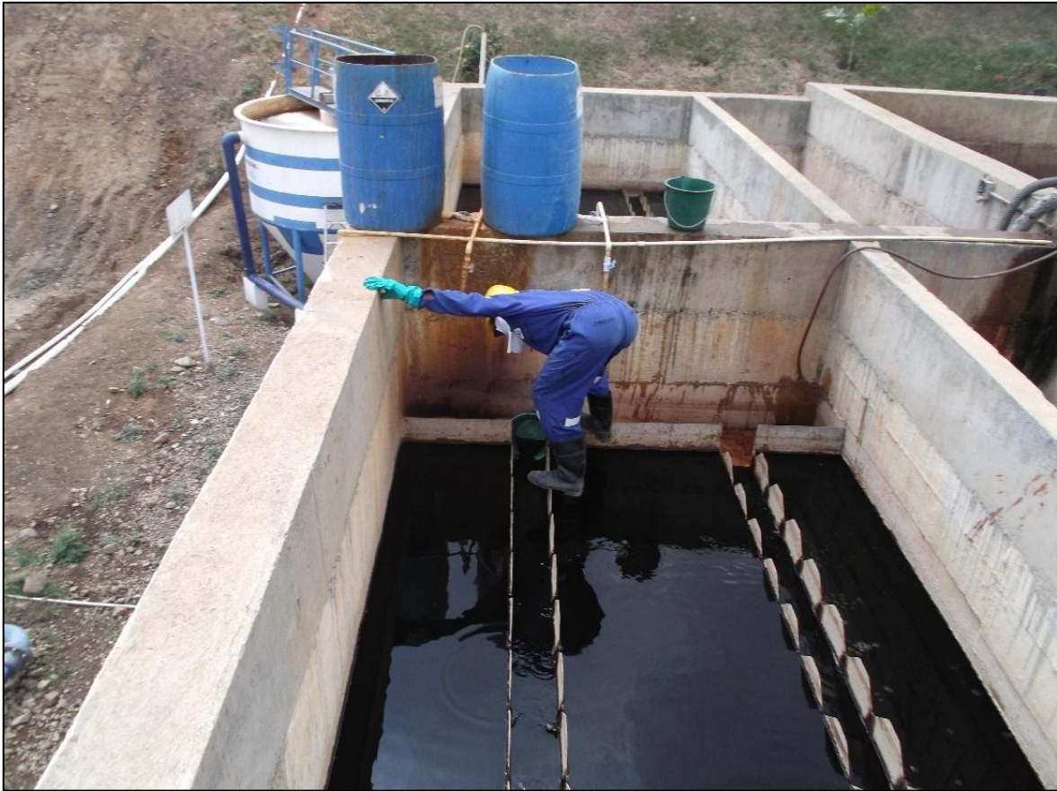
Foto 19. Monitoreo del efluente del tanque sedimentador (lodos activados)
