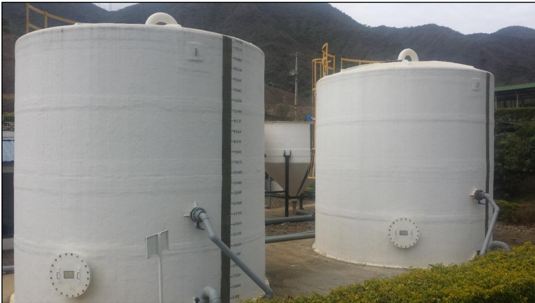
Foto 10. Digestores de lodos
