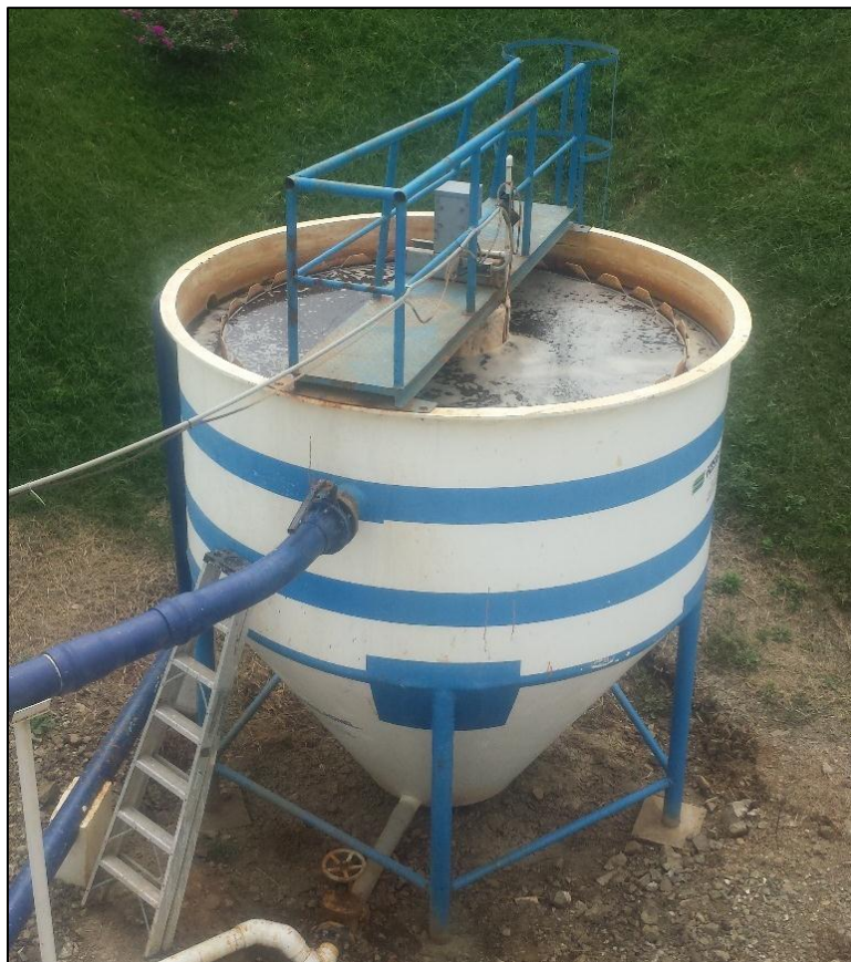
Foto 4. Unidad compacta de clarificación
