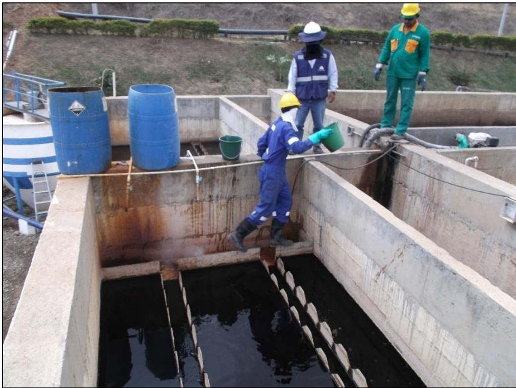
Foto 6. Tanque de sedimentación
