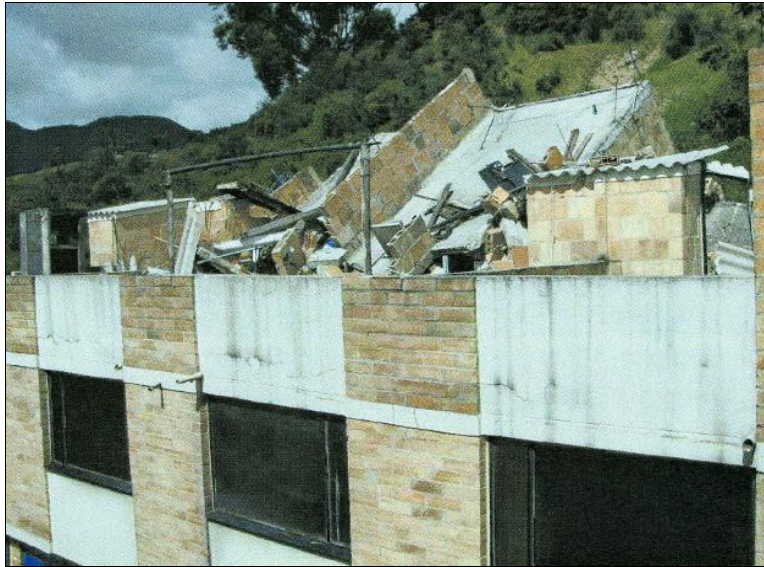
Figura 102. Volcamiento de una de las casas afectadas por el deslizamiento sobre la terraza de la vivienda adyacente. Fuente: Ingeniería y Geotecnia Ltda.
