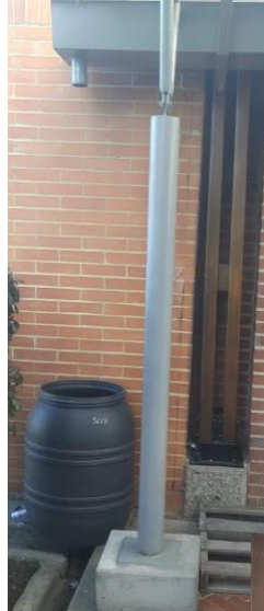
Fotografía 1. Captación de agua lluvia.
